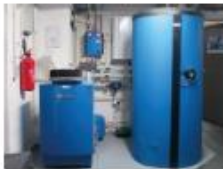
Ölheizung: Energieträger: fossiles Heizöl (erzeugt klimaschädliches CO 2 )
